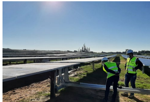
Placas solares - Fuente: Alter Enersun
